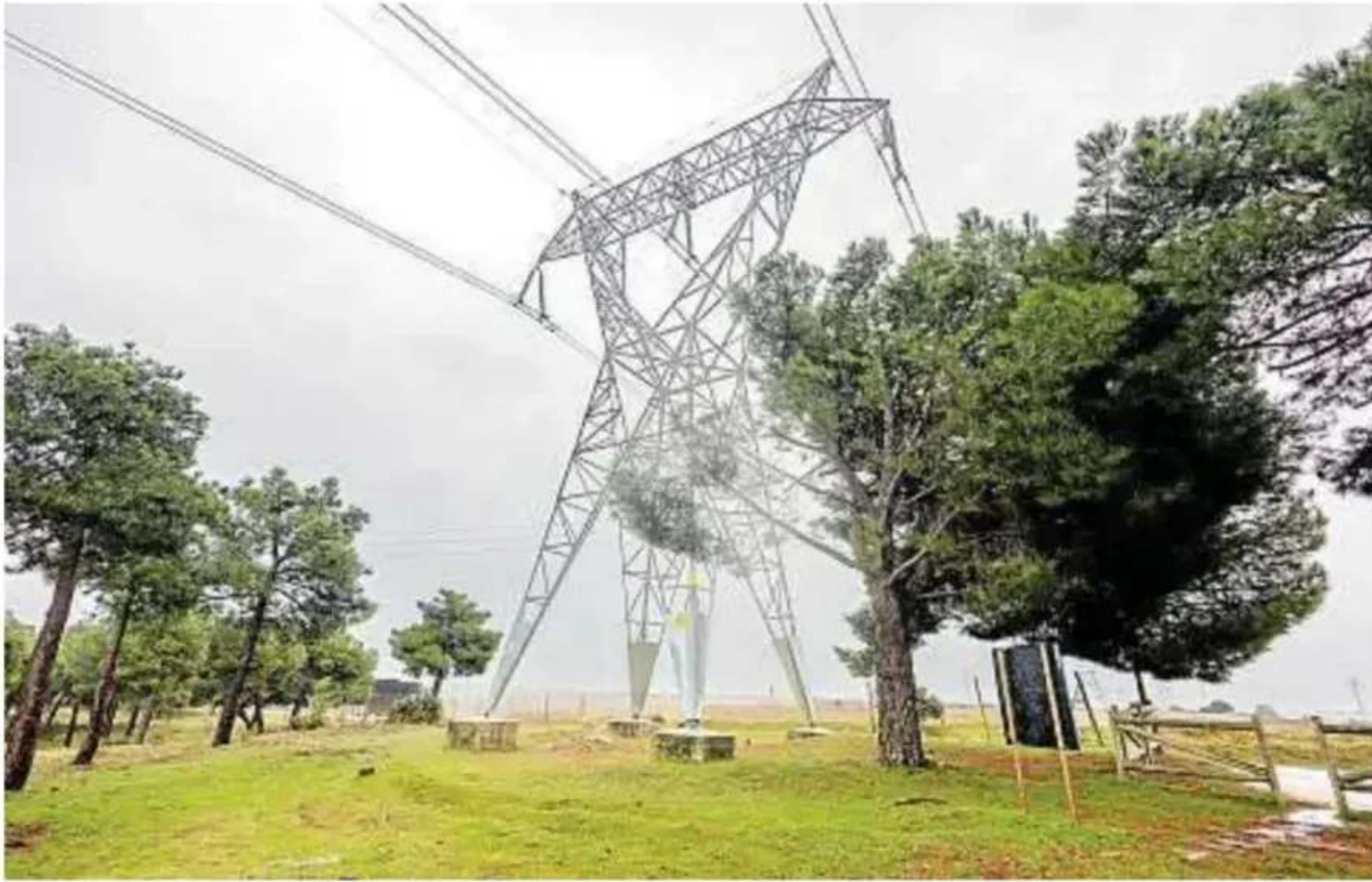
Vista de una torre eléctrica en Madrid. Ricardo Rubio
