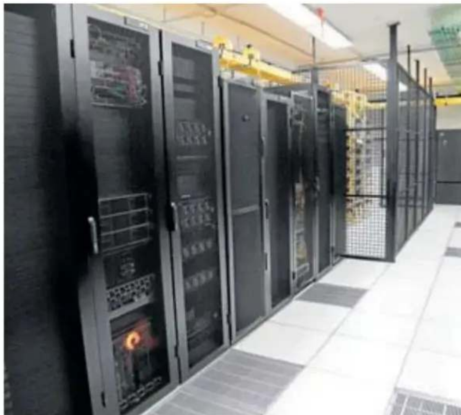
Vista interior de un centro de datos. Manuel Olmedo
