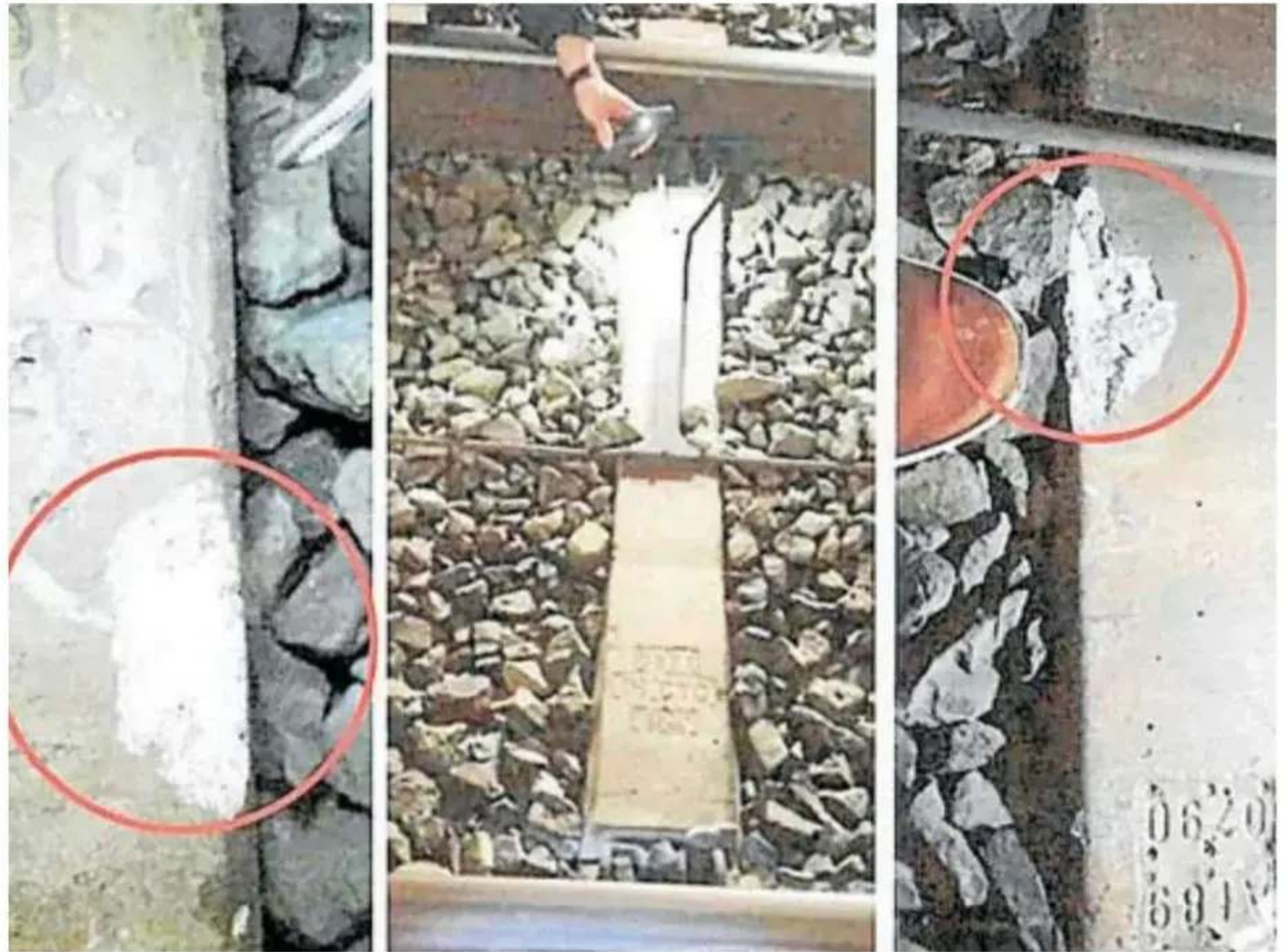
El informe que Adif trasladó a la juez con los daños en las traviesas. ABC
