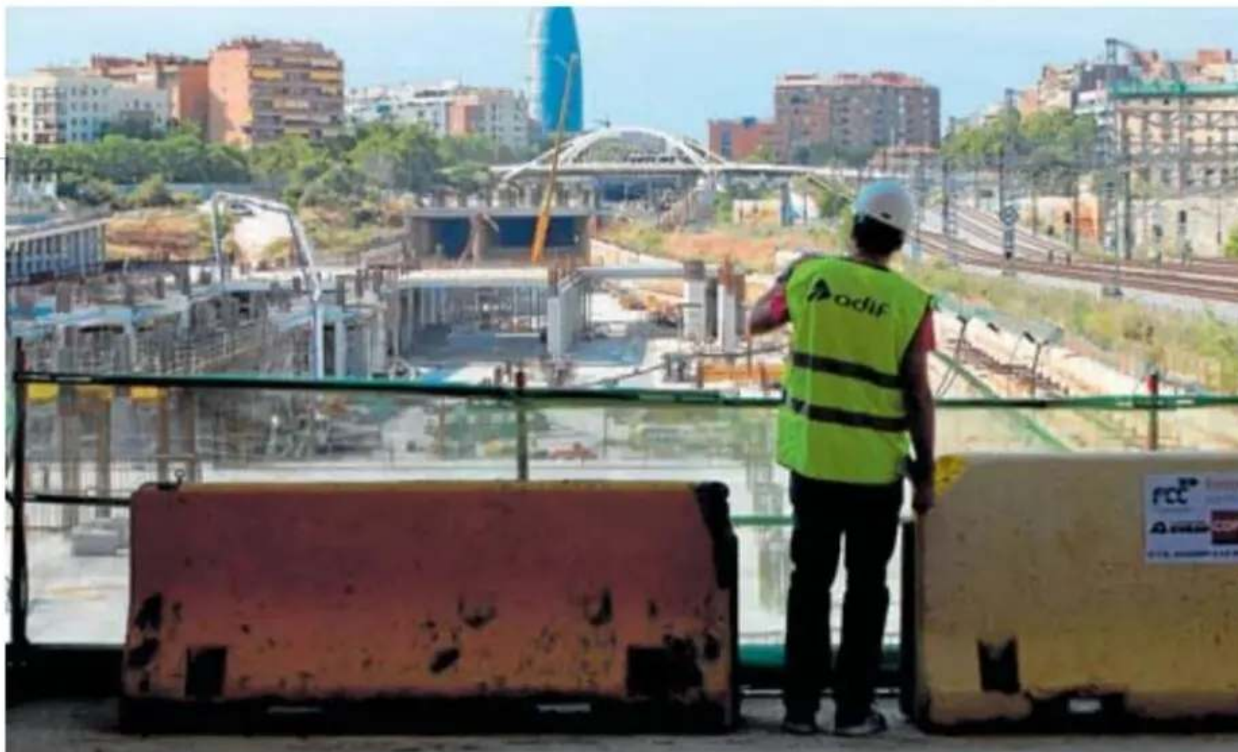
Obras de desarrollo de la Estación de La Sagrera en Barcelona, en el año 2020. EFE
