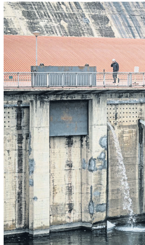
La central hidroeléctrica de Mequinenza
